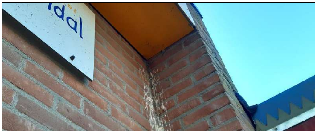
Witte poepstrepen op de muur aan de oostzijde van het gebouw.
