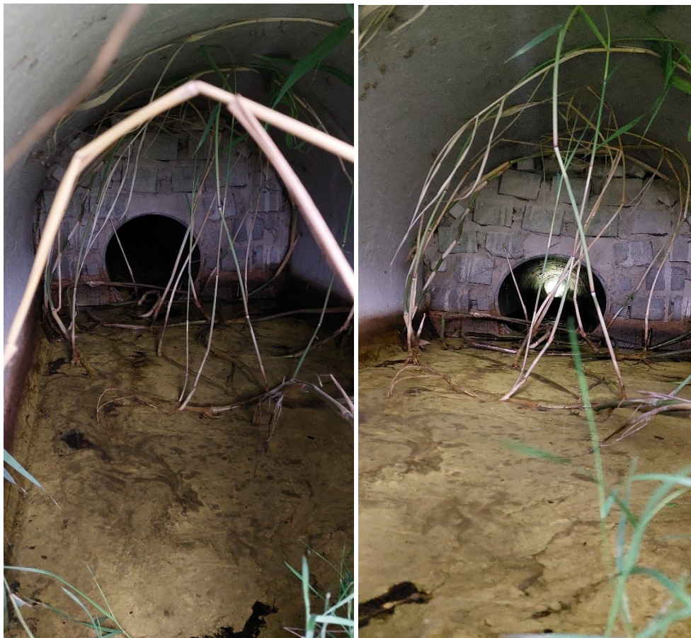
Figuur 3.3 Aan weerszijden van de rechthoekige faunatunnel onder de Hartenseweg (figuur 3.2) liggen ronde duikers die – wanneer deze geen laag water bevatten – geschikt zijn voor passage door soorten als das. Foto's: Ecogroen.
