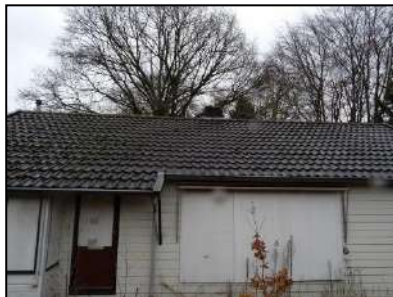
Figuur 15. Zijkant van de bebouwing met betimmering zonder stootvoegen of spleten.
