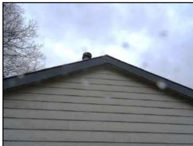
Figuur 14. De kopgevel van de bebouwing op de onderzoekslocatie zonder stootvoegen, of spleten.
