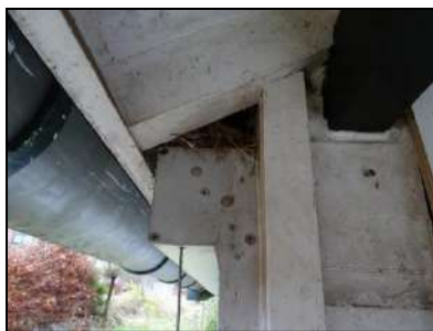
Figuur 10. Zijaanzicht van enkele oude huismussenestten tussen de rolluiken en de dakbedekking van de bebouwing.
