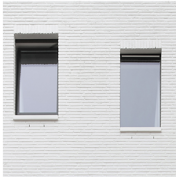
Helder verschil tussen gevelopening en raam
