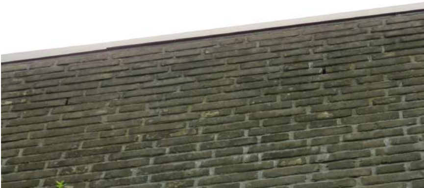
Afbeelding 31: Open stootvoegen in gevel bij entree
