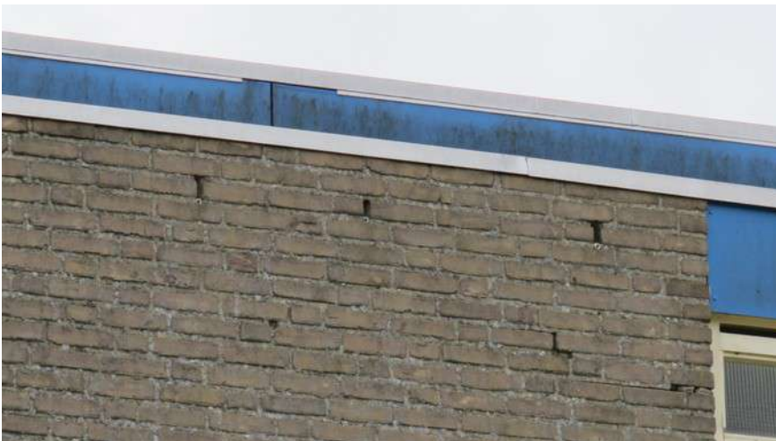
Afbeelding 25: Open stootvoegen in bakstenen geveldeel gebouw A.
