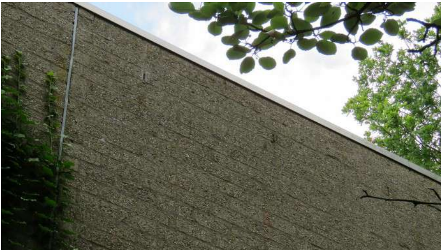
Afbeelding 20: Open stootvoegen in noordwest gevel gebouw A
