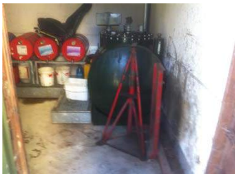
Foto: Olieopslag achter werkplaats
