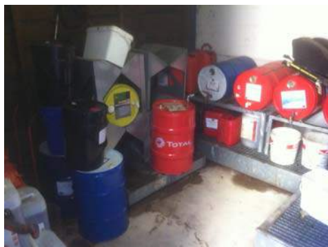
Foto: Olieopslag achter werkplaats
