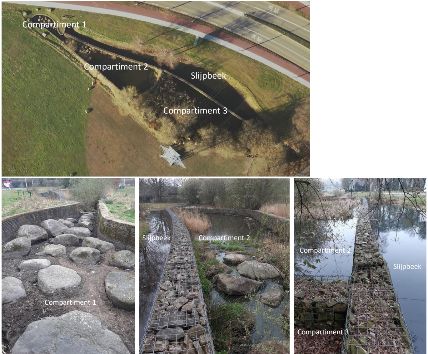
Figuur 6: Overzicht en inrichting bestaand werk met schanskorven t.b.v. opvang hemelwater afkomstig van Utrechtseweg
