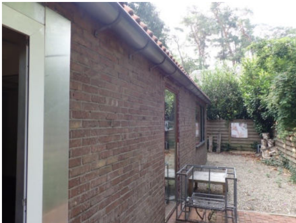
Foto 2: rechts, uitwerpselen van vlemuizen op vensterbank westzijde
