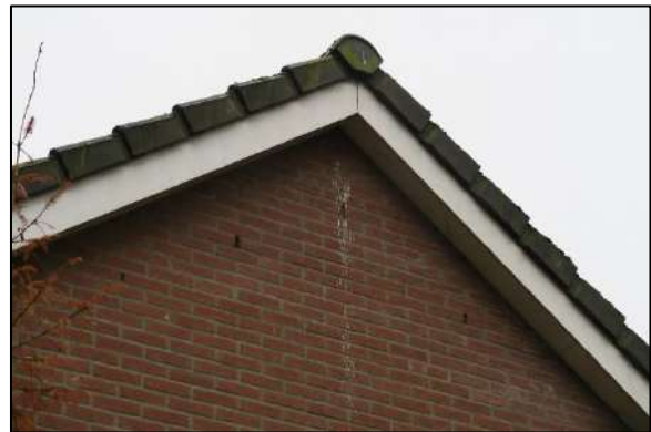
Foto 4. Open stootvoegen en sporen van vogels bij schoolgebouw
