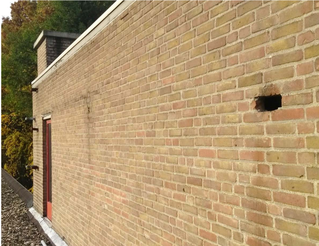
Figuur 3.2 Holte in de muur van de liftschacht die doorgang geeft naar de spouw
