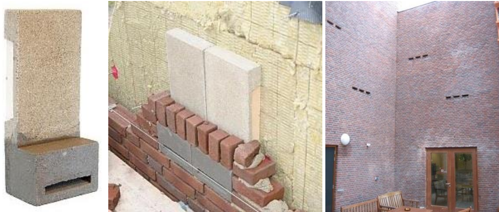
Een inbouwkast kan op een nette manier worden weggewerkt in een spouwmuur.
